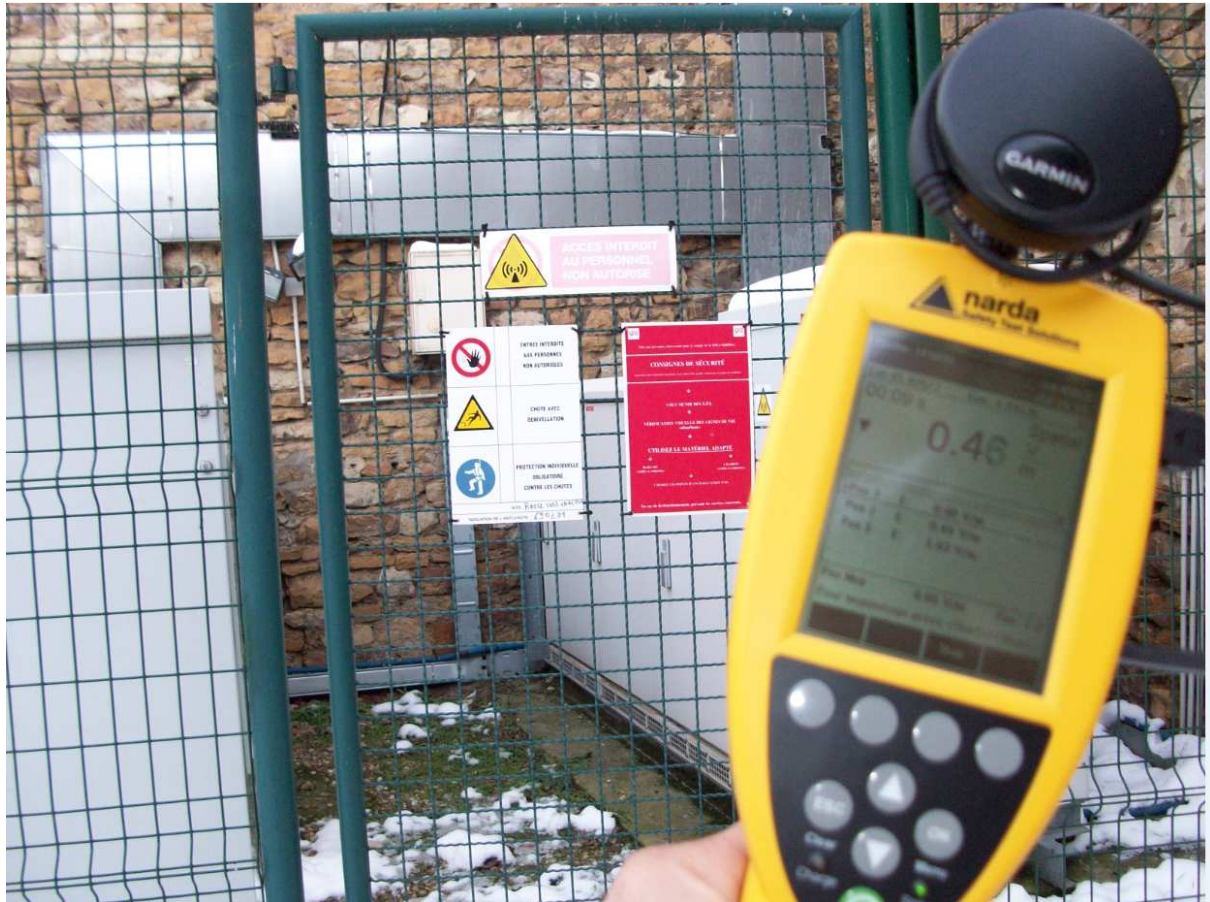
Equipements Baies Radio cellulaires 0,46 V/m
